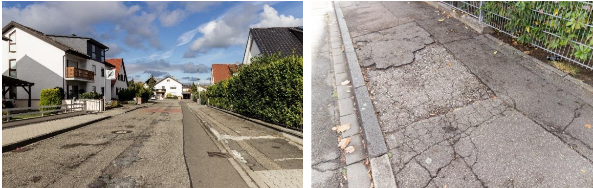
Abbildung 63: Oberflächenzustand in der Leuschnerstraße
